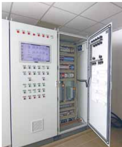
Szafa sterownicza na Stacji Uzdatniania Wody „Zachód”. Fot. M. Misztal.
